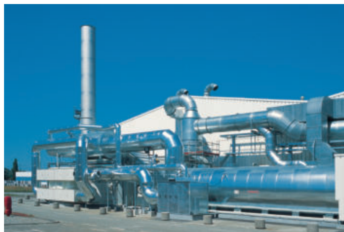
Abluftreinigung durch Adsorption.
