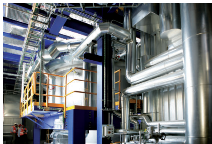
Wirbelschichtanlage zur Aufbereitung von Ölschiefer im Zementwerk.
