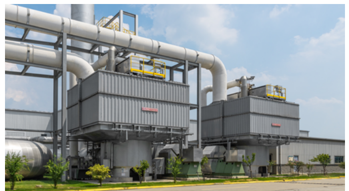
RNV zur Abluftbehandlung
