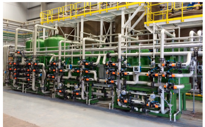
VE-Kreislaufführung mit einer Kapazität von 25 m 3 /h für Spülwasserrecycling.
