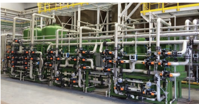
VE-Kreislaufanlage mit einer Kapazität von 25m 3 /h für Spülwasserrecycling.
